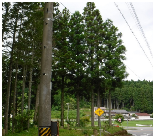
防犯灯設置（南区）
